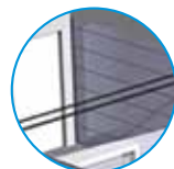
Instalacja rurowa czynnika chłodniczego (oraz skrzynka BS*)
